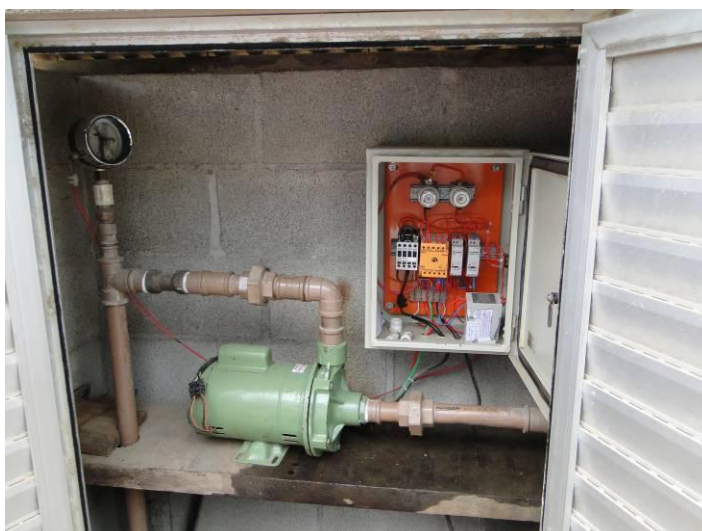
Figura 25– Booster 02 para aumentar a pressão da rede de abastecimento.
