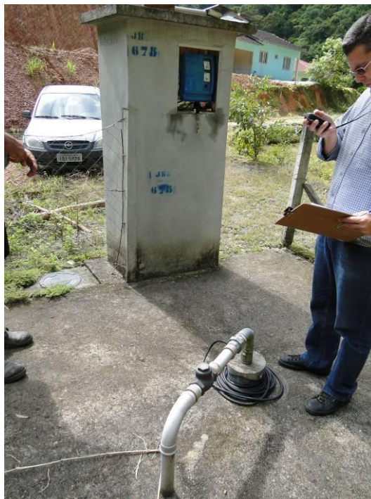
Figura 6– Captação de água bruta em poço profundo – Comunidade Lajeado. Fonte: Visita Técnica STE, 2010.
