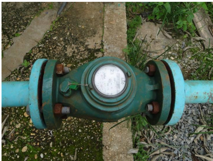
Figura 18– Sistema CASAN: Macromedidor após captação. Fonte: Visita Técnica STE, 2010.
