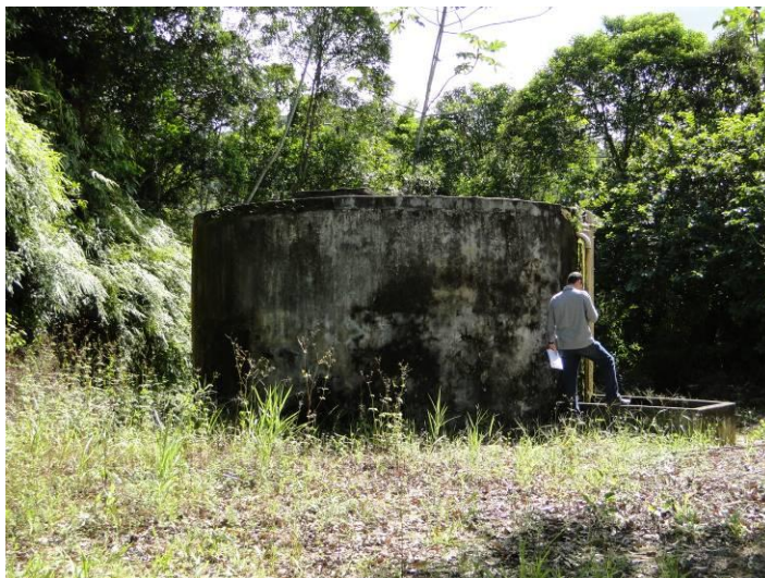
Figura 11– Reservatório com 25 m³ de capacidade – Comunidade Águas Negras. Fonte: Visita Técnica STE, 2010.
