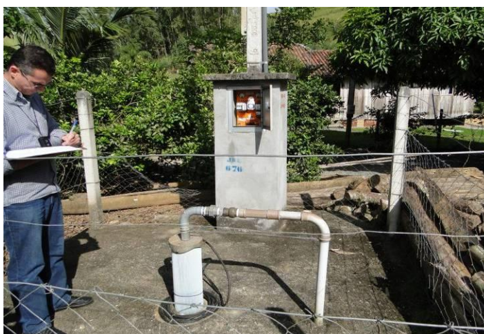
Figura 3– Captação de água bruta em poço profundo – Ribeirão do Ouro. Fonte: Visita Técnica STE, 2010.
