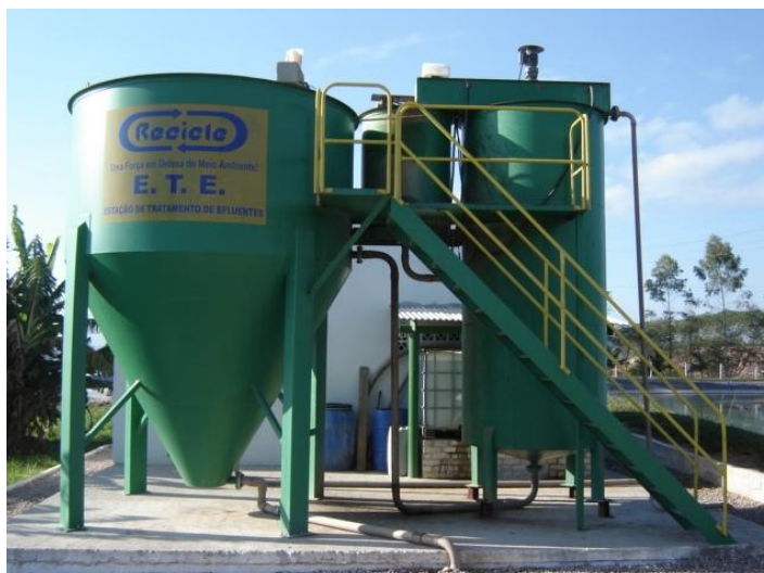
Figura 37– Sistema de tratamento de líquidos percolados. Fonte: RECICLE
