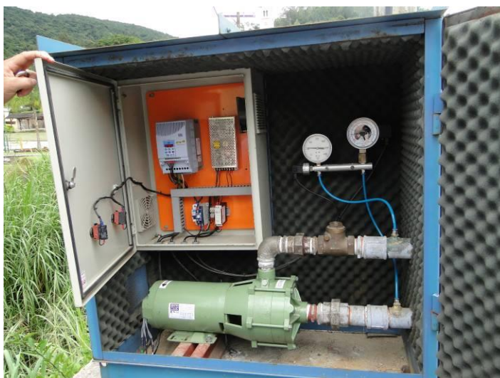
Figura 24– Booster 01 para aumentar a pressão da rede de abastecimento. Fonte: Visita Técnica STE, 2010.
