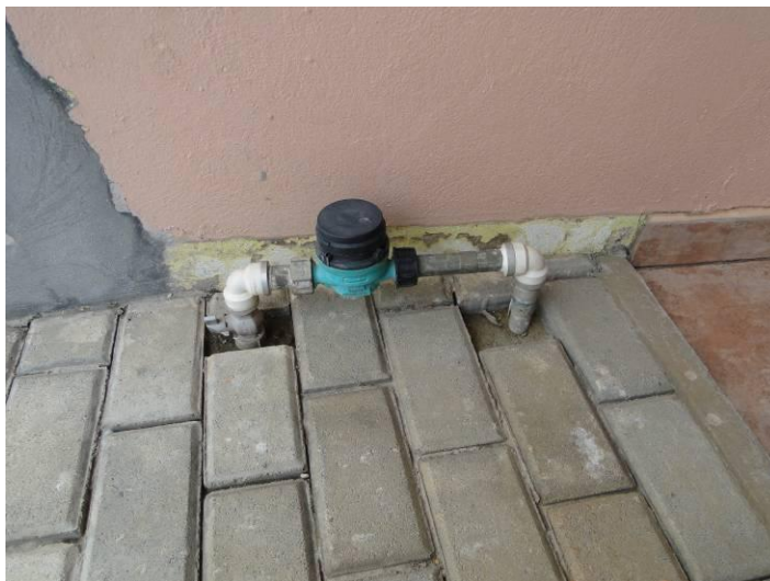
Figura 23– Micromedidor do sistema de abastecimento da CASAN. Fonte: Visita Técnica STE, 2010.
