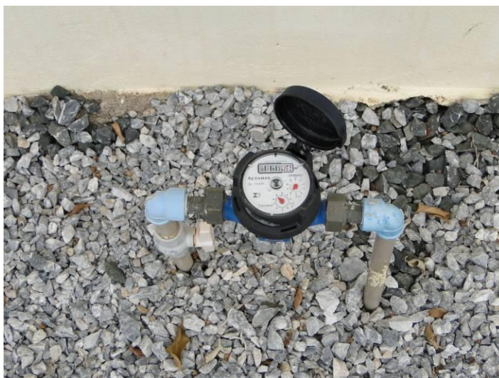
Figura 14– Micromedidor do sistema de abastecimento da Prefeitura Municipal. Fonte: Visita Técnica STE, 2010.
