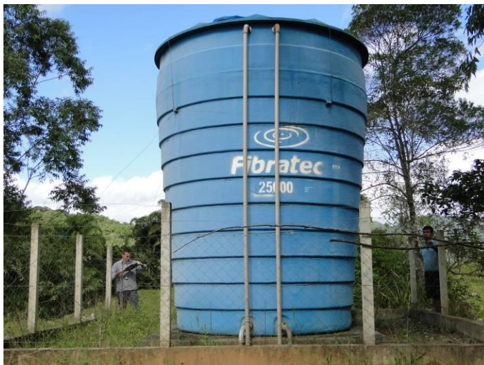
Figura 4– Reservatório com 25 m 3 de capacidade – Ribeirão do Ouro. Fonte: Visita Técnica STE, 2010.
