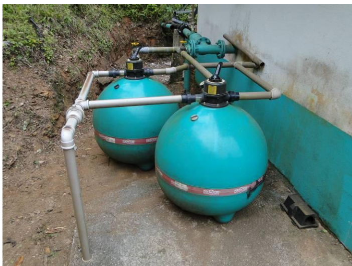
Figura 20– Sistema CASAN: Filtros de Areia. Fonte: Visita Técnica STE, 2010.
