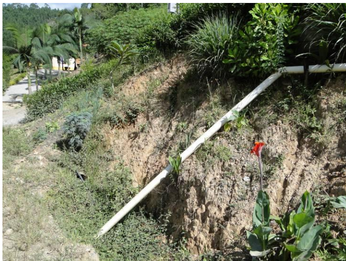
Figura 26– Lançamento de esgoto em vala de drenagem pluvial. Fonte: Visita Técnica STE, 2010.
