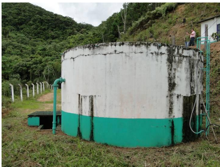
Figura 22– Sistema CASAN: Reservatório com 50 m³ de capacidade – sede do Município Fonte: Visita Técnica STE, 2010.
