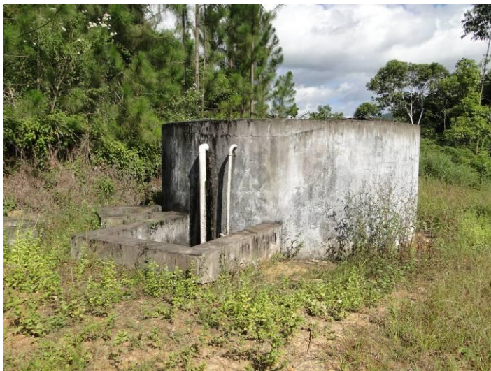
Figura 5– Reservatório com 30 m 3 de capacidade – Comunidade Ribeirão do Ouro. Fonte: Visita Técnica STE, 2010.
