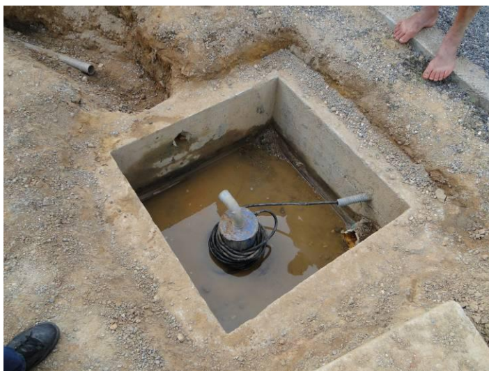
Figura 12– Captação de água bruta em poço profundo – Comunidade Salto Águas Negras. Fonte: Visita Técnica STE, 2010.
