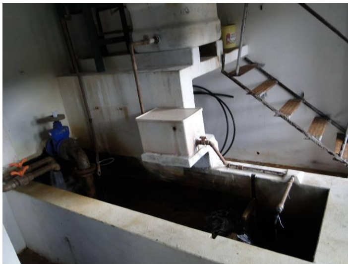
Figura 21– Sistema CASAN: Dosagem de cloro e flúor. Fonte: Visita Técnica STE, 2010.
