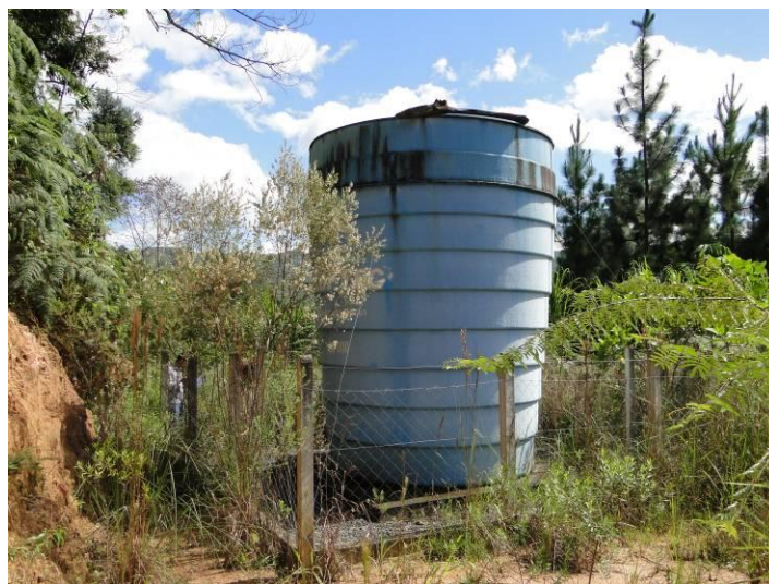
Figura 7– Reservatório com 25 m³ de capacidade – Comunidade Lajeado. Fonte: Visita Técnica STE, 2010.
