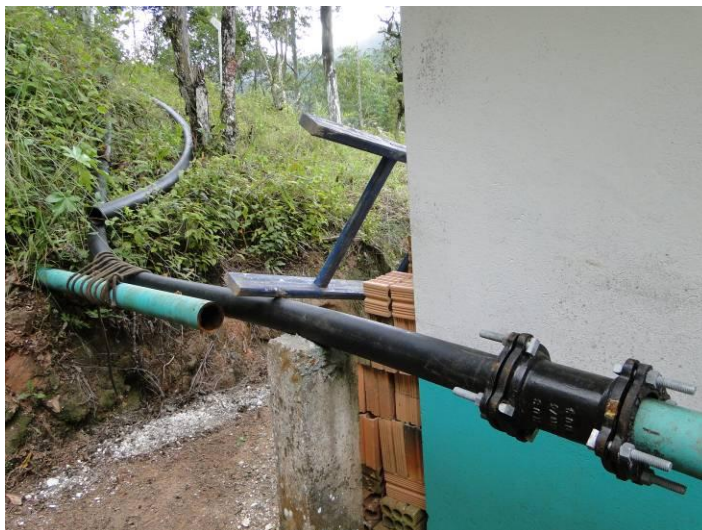
Figura 19– Sistema CASAN: Adutora de água bruta – Ø75 mm em PEAD. Fonte: Visita Técnica STE, 2010.
