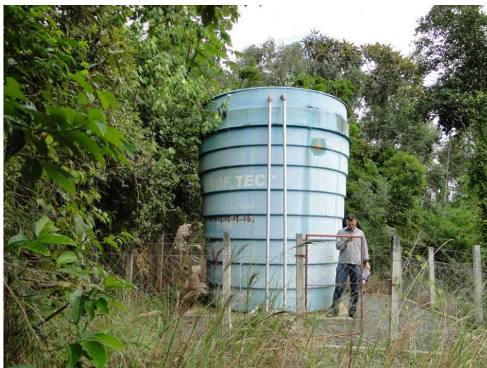
Figura 9– Reservatório com 25 m³ de capacidade – Comunidade Pedras Grandes. Fonte: Visita Técnica STE, 2010.
